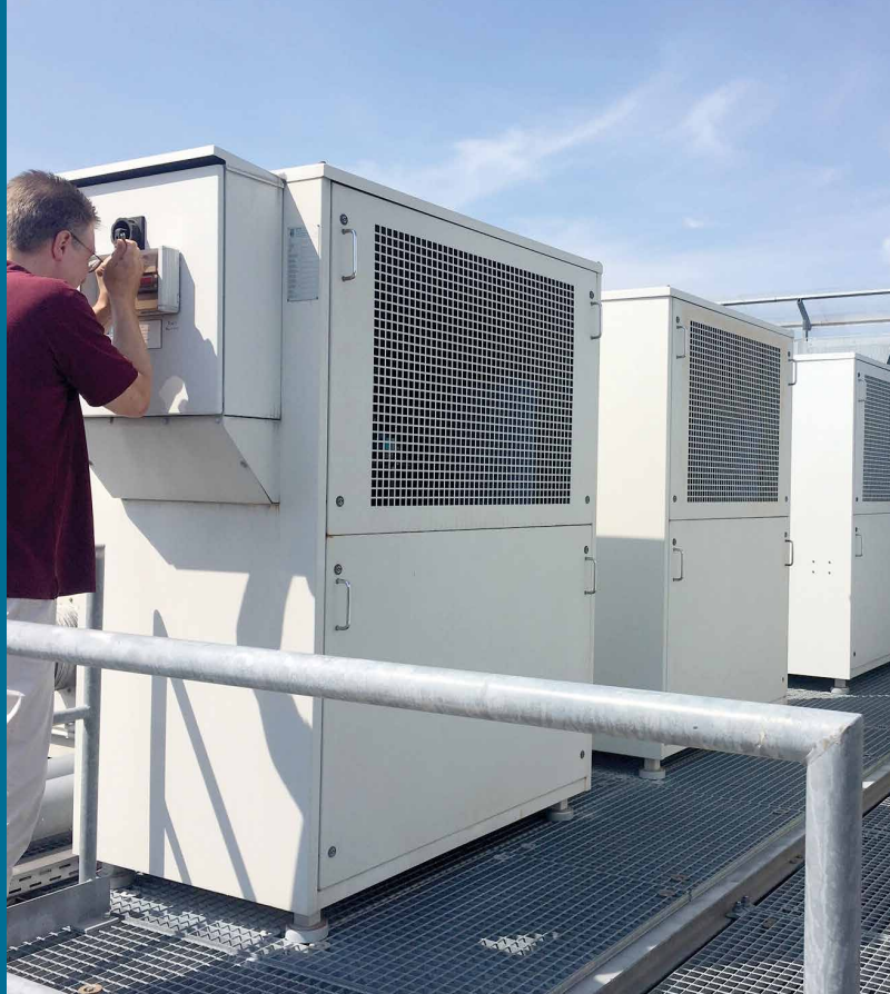
Für den Serverraum in Freiburg wurde eine neue Clusterkühlung auf dem Dach des Institutsgebäudes aufgestellt.
